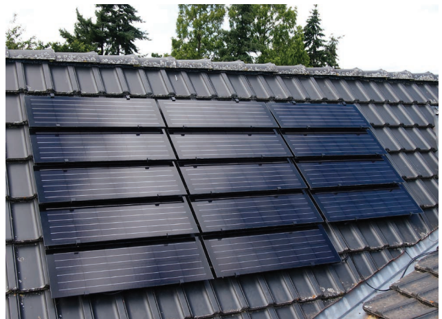
Kleines SOLo-System auf dem Dach
